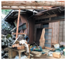
土砂につぶれそうな家屋 (相模原市緑区)
